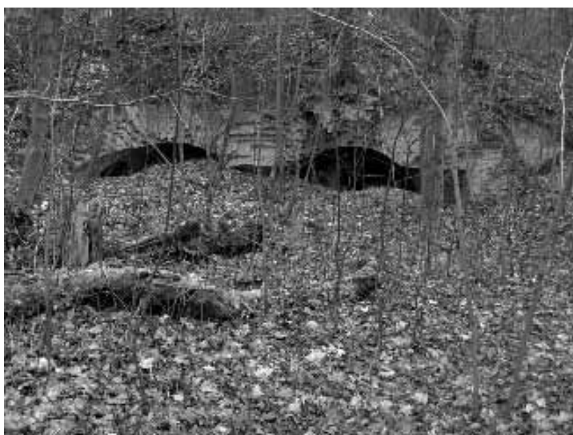
Foto 5: Zniszczony blokhauz obrony bramy fortu
